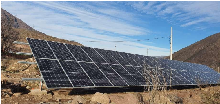
Vista general del sistema fotovoltaico APR Alicahue.
