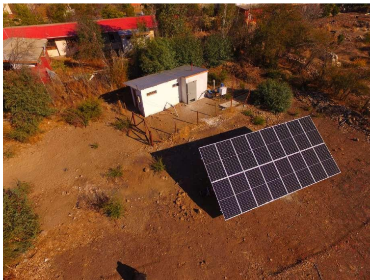
Vista general del sistema fotovoltaico APR La Mora.
