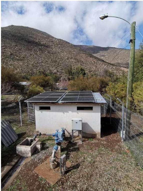
Vista general del sistema fotovoltaico APR Alicahue - Los perales.
