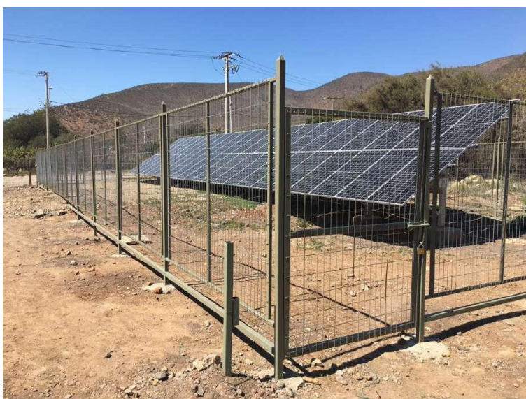
Vista general del sistema fotovoltaico APR San Lorenzo.
