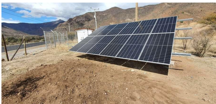
Vista general del sistema fotovoltaico APR El Guayacán.
