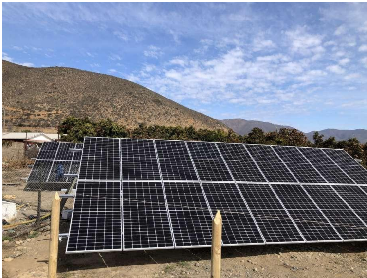
Vista general del sistema fotovoltaico APR Artificio Paradero 4.
