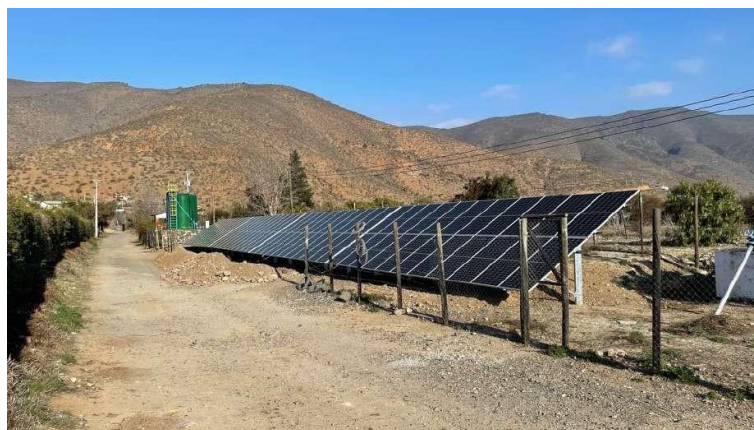
Vista general del sistema fotovoltaico APR Cooperativa Artificio.
